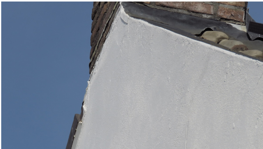
Afbeelding 7: De kopse gevel van de St. Elizabethstraat nr. 17 heeft geen overhangende dakpannen en is daarmee ongeschikt voor vleermuizen, toch bestaan er kleine openingen onder loodflappen waar vleermuizen van gebruik zouden kunnen maken.
