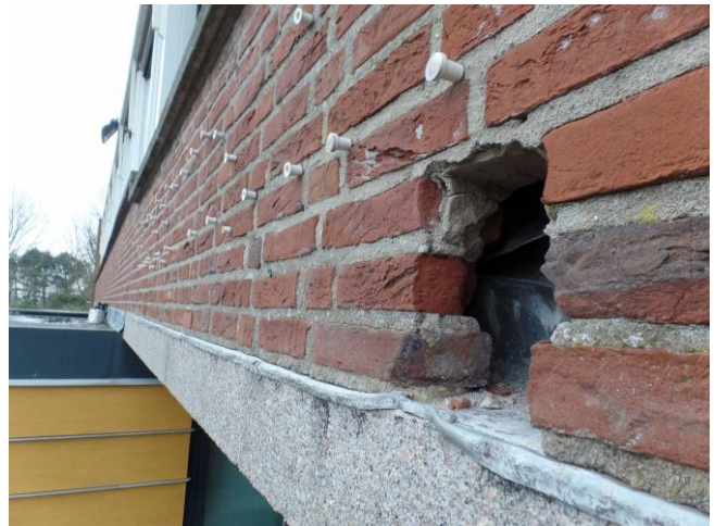
Figuur 9: gaten in de muur zorgen voor tocht
