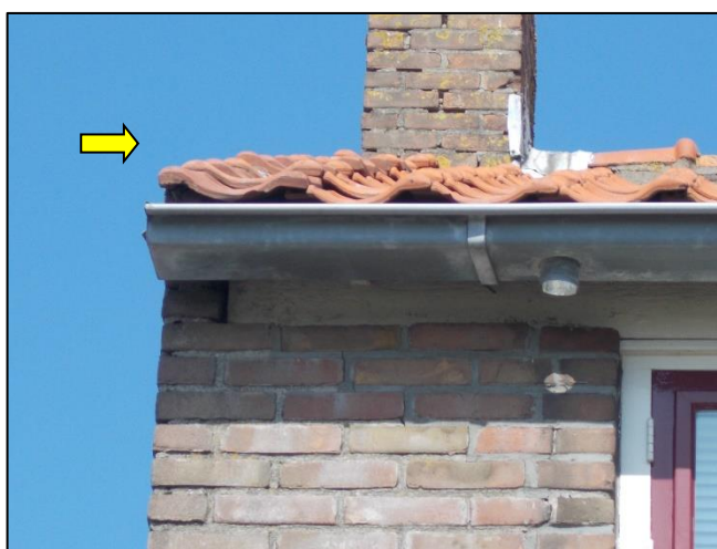
Figuur 10: Gierzwaluw geschikte openingen onder de dakpannen van de bebouwing. Bron: NWC
