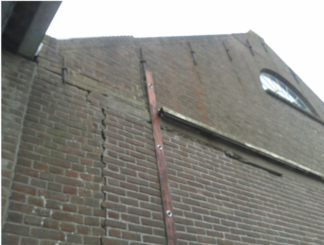
Figuur 2: Scheuren in dit gebouw kunnen toegang bieden aan vaste paar- en verblijfplaatsen van vleermuizen, evenals de gaten waar de borgpennen van de dakconstructie inhangen.
