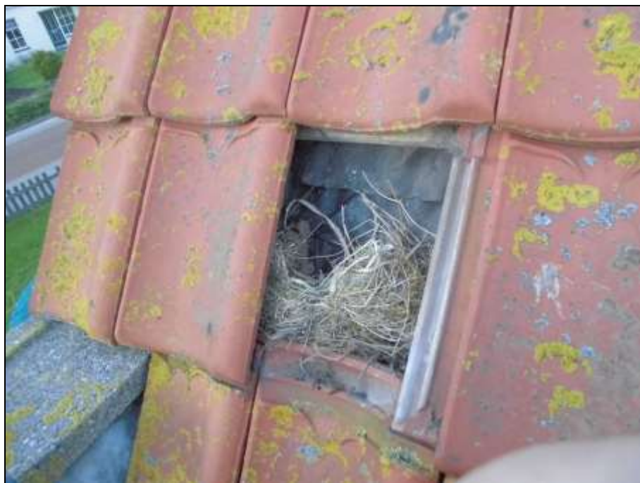
Figuur 8. Nestplaats huismus onder dakpan
