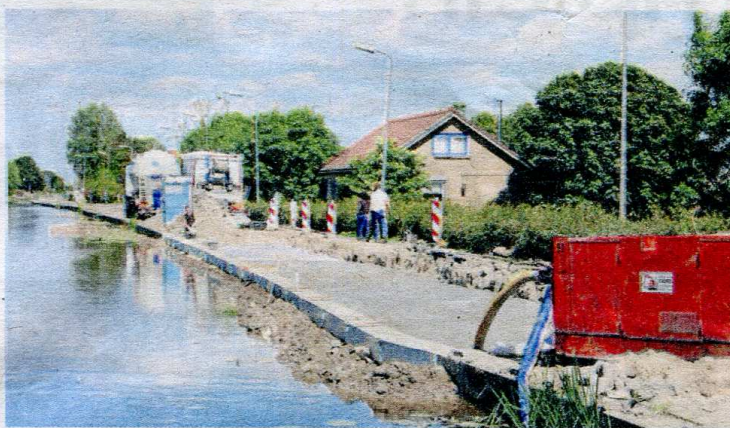
Een deel van de Stompwijkseweg is al onder handen genomen, maar vanwege recente verzakkingen is een duurzaam en structureel herstel onontkoombaar (archieffoto).
