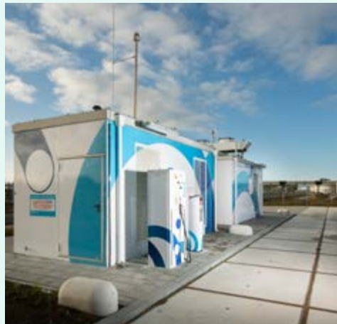
Waterstof-tankstation voor openbaar vervoer, Delfzijl.
