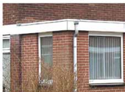
voldoet niet, de detaillering is te grof
