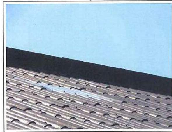
Foto 12: dichte nok- en dakpannen koeienstal
