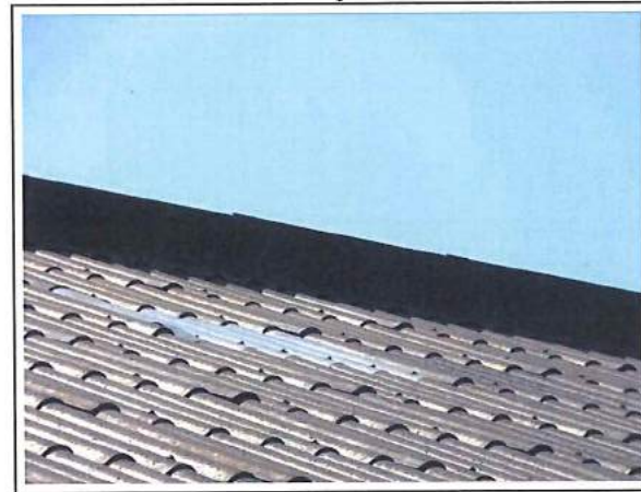
Foto 12: dichte nok- en dakpannen koeienstal
