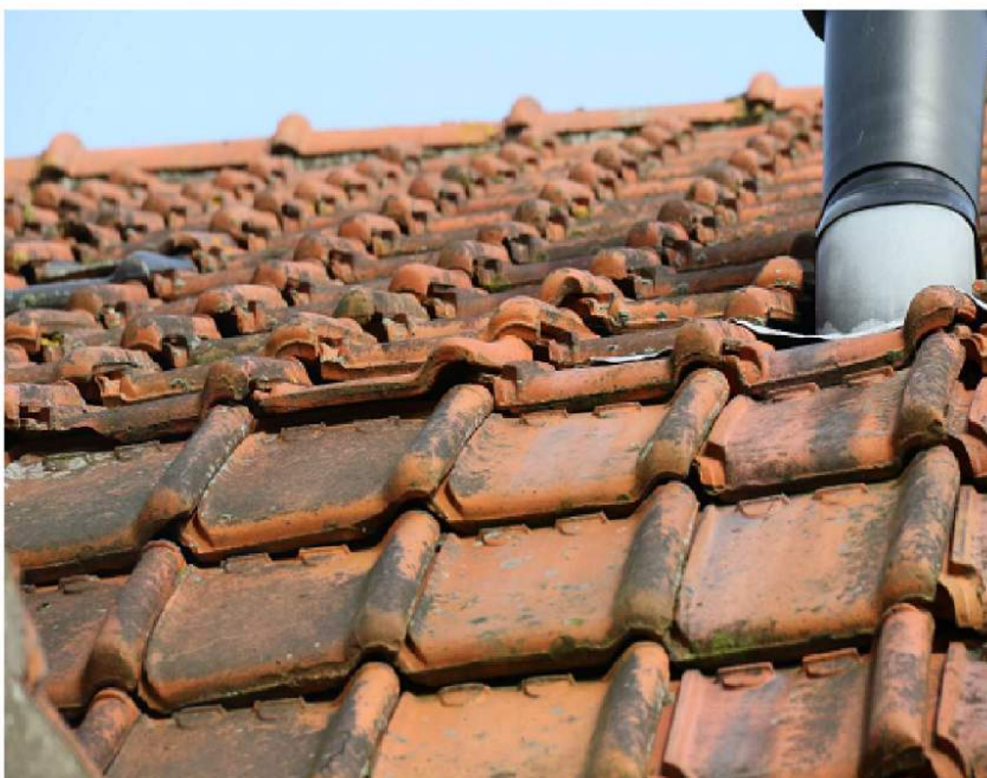
Spleten tussen dakpannen en daklood kunnen toegang geven naar voor vleermuizen geschikte holtes.
