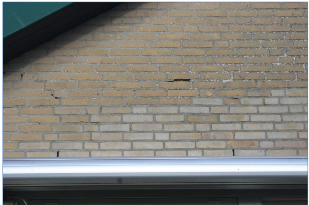
Uitgevallen lintvoegen en kleine ontluchtingsopeningen.
