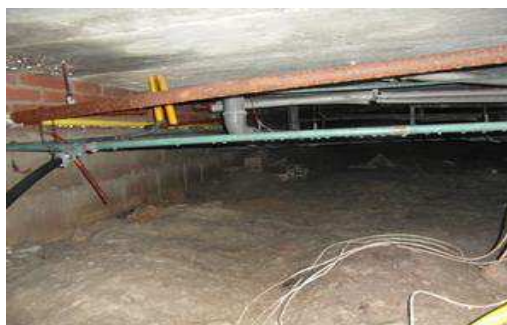
Foto 13: Riolering van pvc
