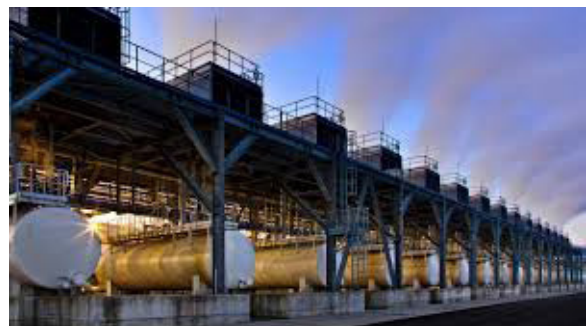
rijen met koeltorens en tanks daaronder
