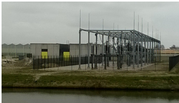
Bestaande station ECW 2012. Rechts de open schakeltuin voor het hoogspanningsdeel. De kabels zijn hier bovengronds voor plaatsing van de veiligheidsschakelaars. De twee bouw-werken zijn; rechts de beton ommuurde transformatoren en links het middenspanning schakelgebouw.
