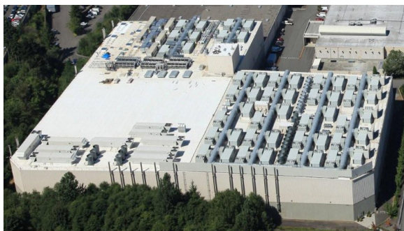
luchtkoeling units op dak hoger datacenter
