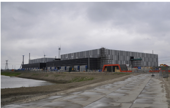
Google Datacentre Eernshaven Eernshaven, Nederland
