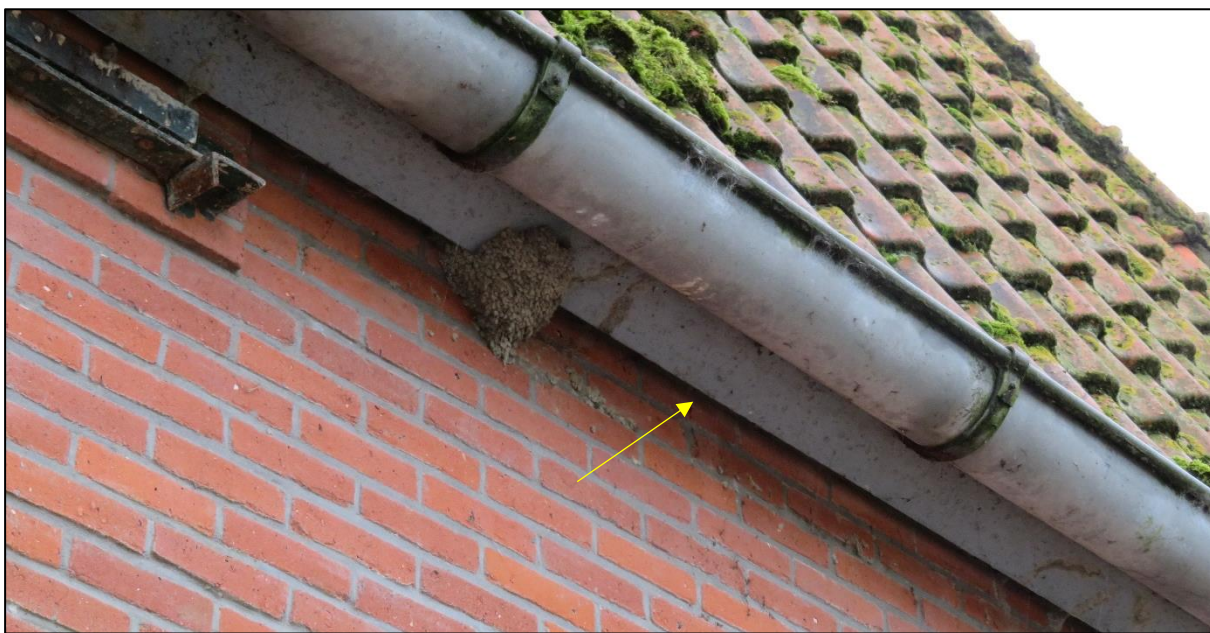
Afb 19: Kier tussen gootbetimmering en metselwerk geschikt als in- en uitvliegopening
