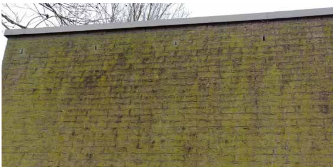
Open stootvoegen in een buitenmuur
