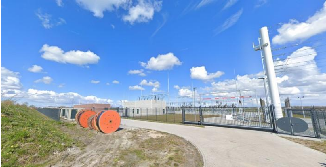
afbeelding 4: aanzicht toegang met links het bedieningsgebouw van Liander, in het midden grijswit zijn de transformatorruimten en daar achter en rechts de schakelvelden en afspanportalen (bron: google street-view)
