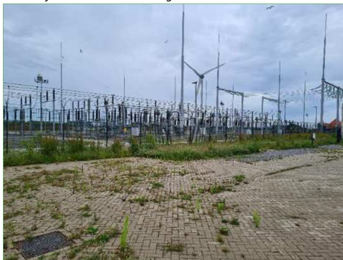
Overzicht van de electriciteitsstation.
