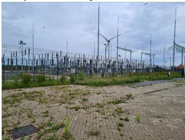
Overzicht van de electriciteitsstation.
