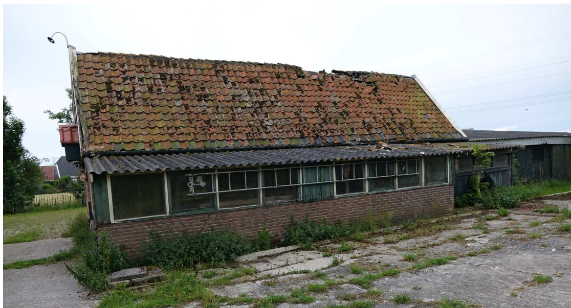
Figuur 4. Schuur met deels ingestorte nok.
