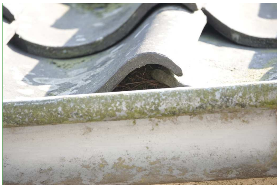
Nestmateriaal waarneembaar onder een dakpan aan de zijgevel.
