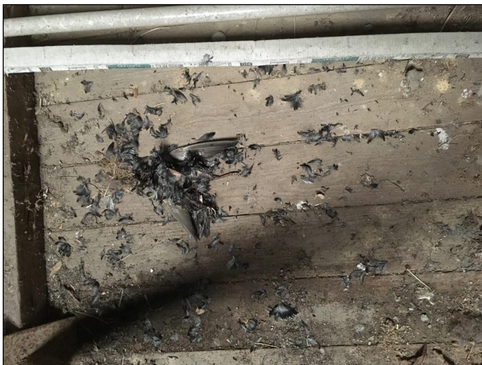
Figuur 12 Dode spreeuw op zolder schuur, vermoedelijk aangevreten door vogels of muizen.
