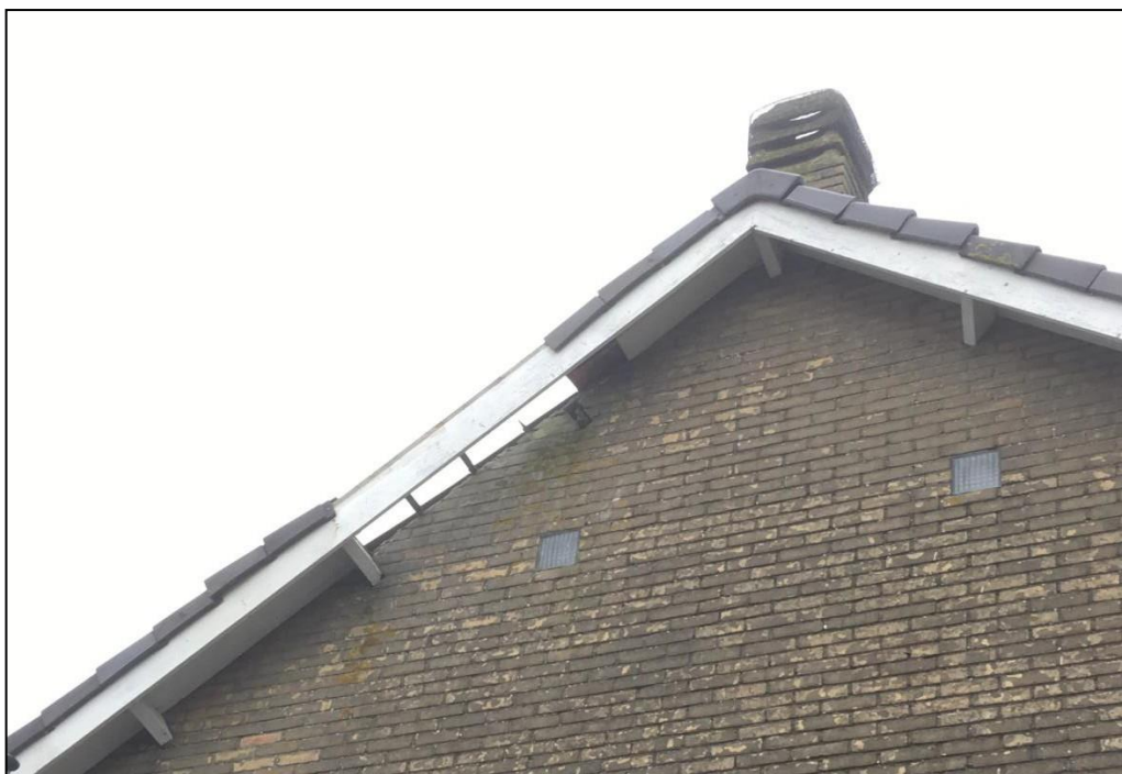
Figuur 2 De schoorsteen is geschikt voor vleermuizen en vogels en vleermuizen kunnen via scheve dakpannen en de afgebroken dakbalk onder het pannendak komen
