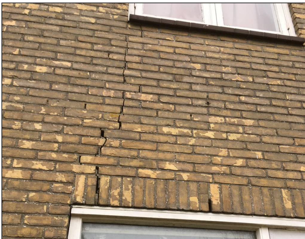
Figuur 3 Open stootvoegen en grote scheuren in metselwerk zijn geschikt voor vleermuizen
