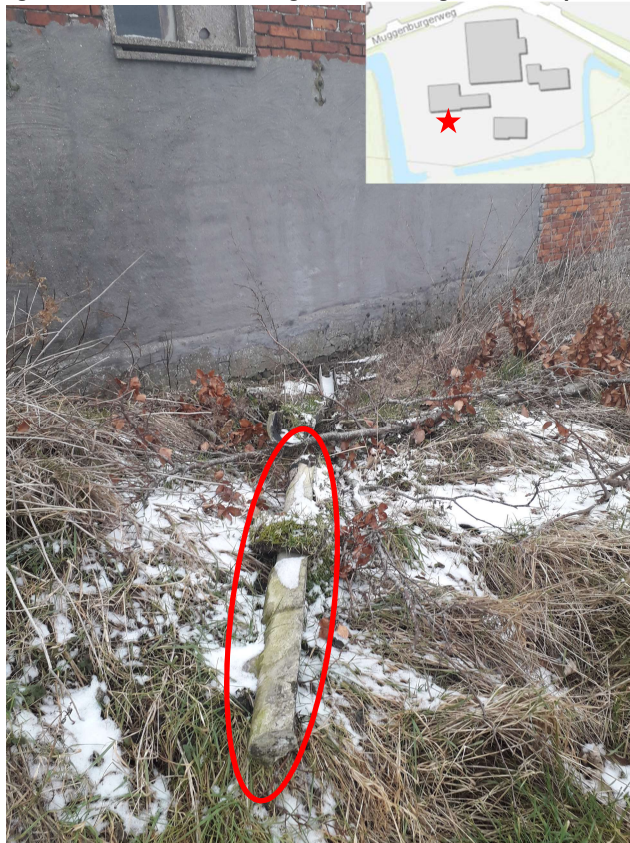
Figuur 6; Asbestverdacht fragment van dakgoot en vindplaats (ster)
