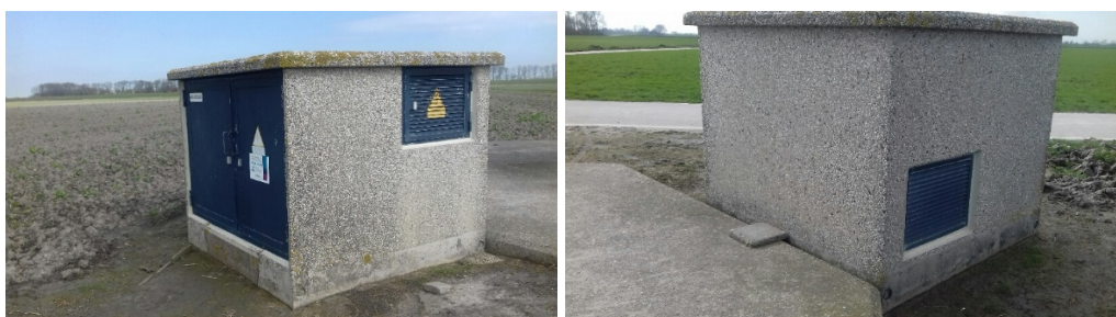
Figuur 4.22 Voor- en achteraanzicht inkoopstation bij bestaande windturbines
