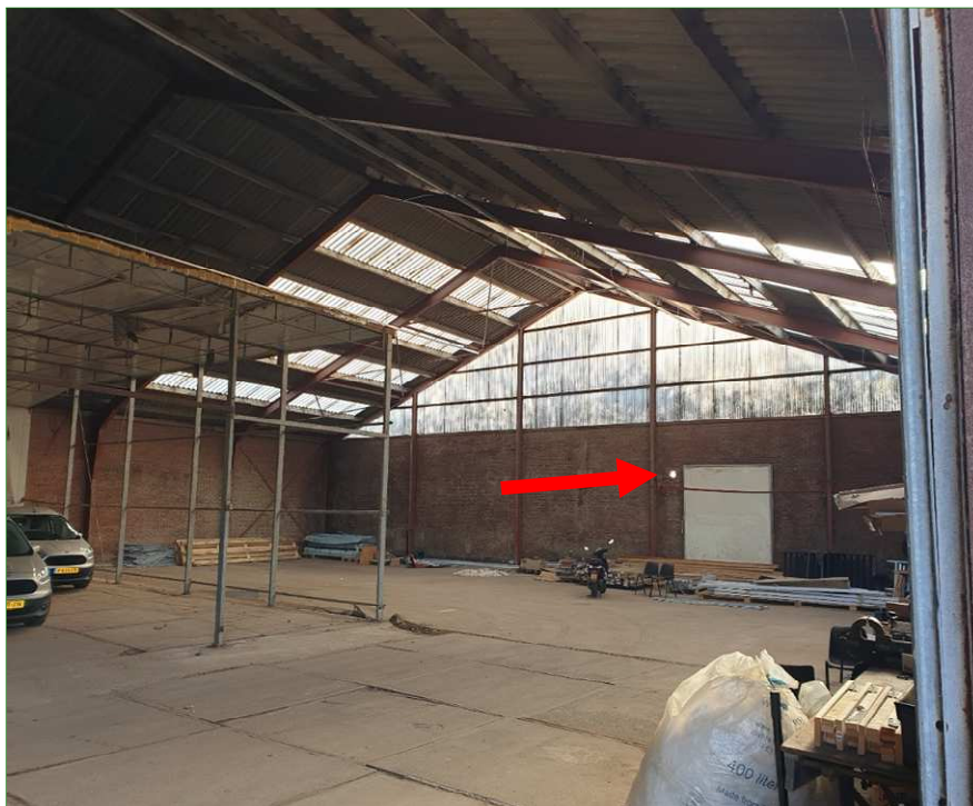
De loods met gat in de muur(rode pijl).
