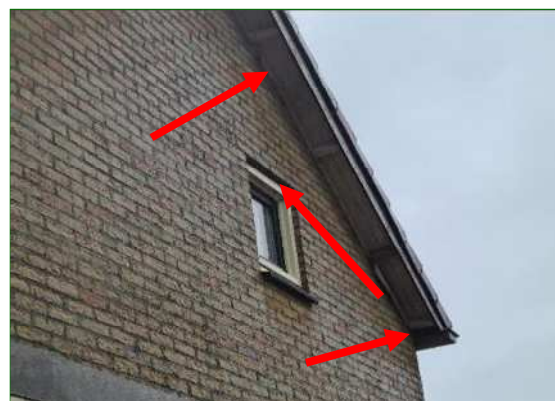
De openingen onder dakranden en rondom kozijnen van de woning (rode pijl) geven mogelijk toegang tot voor vleermuizen geschikte achterliggende ruimtes.
