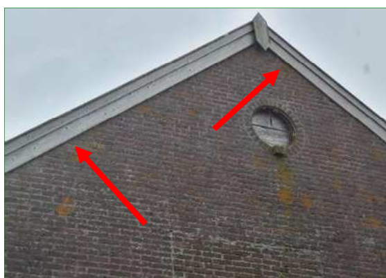
De openingen onder daklijsten van de schuur (rode pijl) geven mogelijk toegang tot voor vleermuizen geschikte achterliggende ruimtes.
