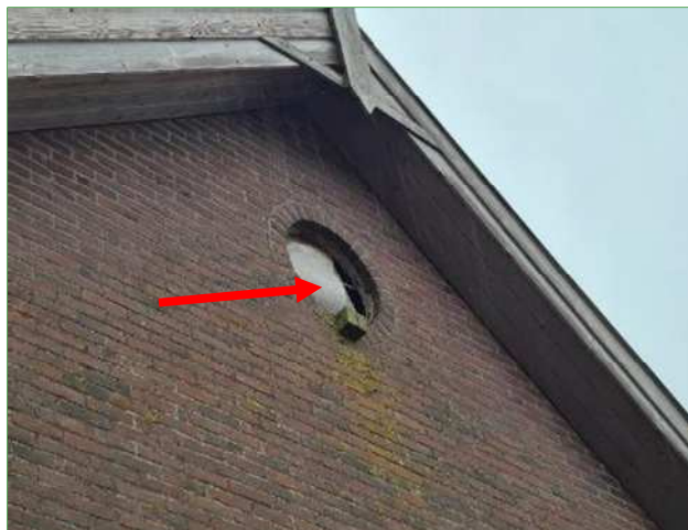
Gat in de nok van de schuur met ontbrekend raam. Deze biedt een geschikte doorgang voor Kerkuil.
