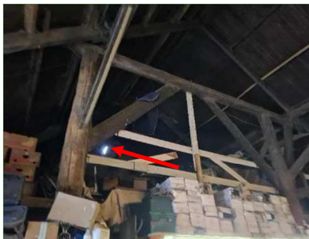
Ontbrekende raam in de nok (rode pijl) en opgeslagen materialen op de zolder. Deze zolder met opgeslagen materialen biedt potentieel geschikte locaties voor de Kerkuil om te verblijven of broeden.
