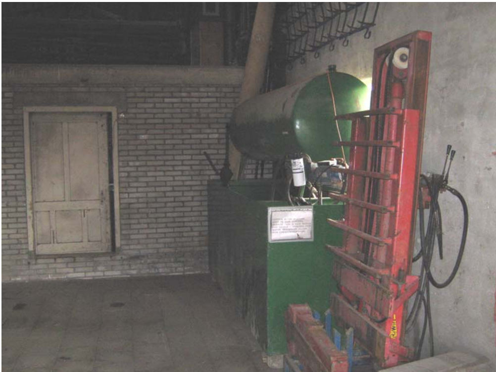
Foto 2. Deellocatie "Polderweg 28". Zicht op de twee boven elkaar gestapelde gasolietanks in een bezinkbak.
