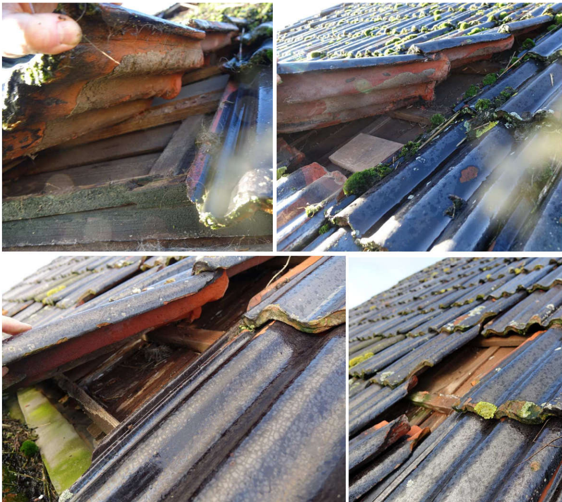
Figuur 4. Mogelijk nestlocaties van huismus zijn niet aangetroffen onder de dakpannen.
