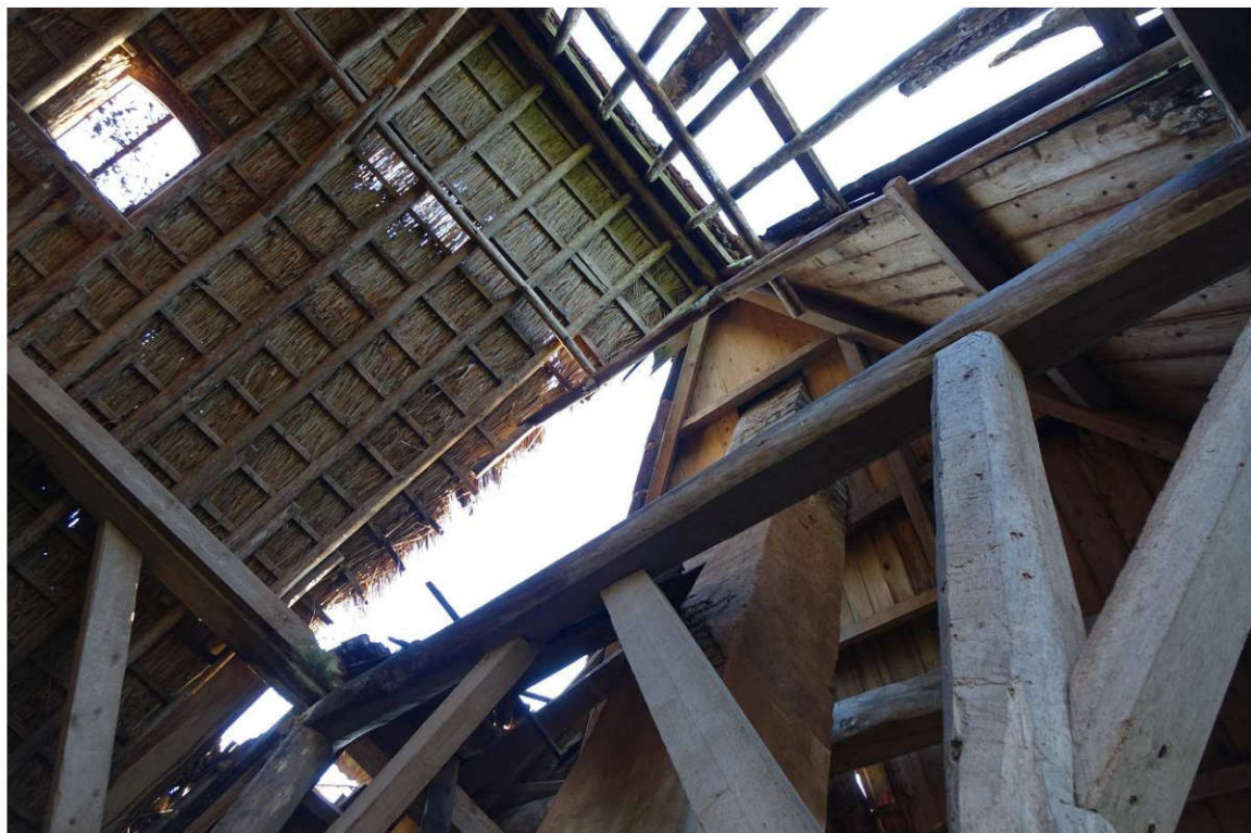
Figuur 4. Nok en dakconstructie van de stolp in zeer slechte staat en is vanwege het ontbreken van tochtvrije ruimtes niet geschikt als verblijfplaats voor vleermuizen.
