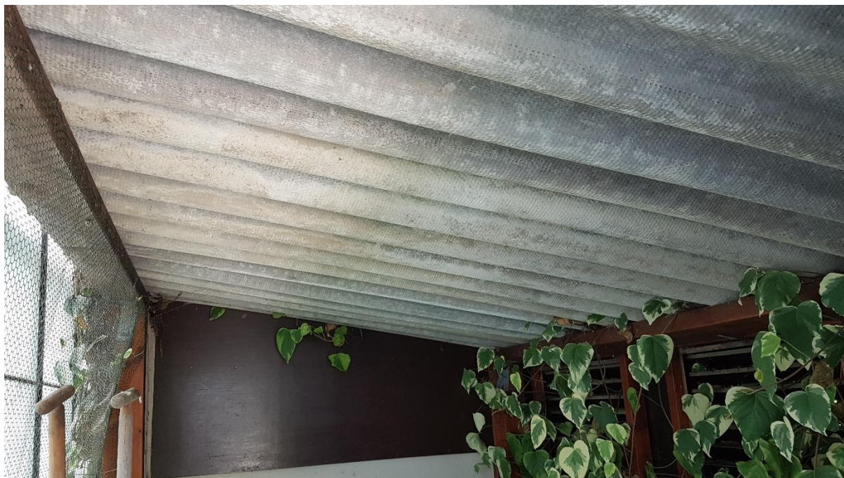
Onderzoekslocatie, stalling met asbestverdacht (golfplaten)dak
