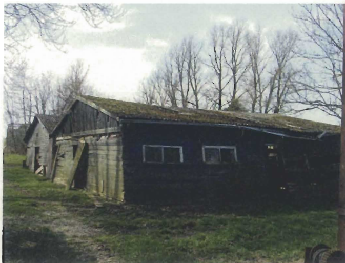
Schuren 1 en 2 met asbesthoudende golfplaat.
