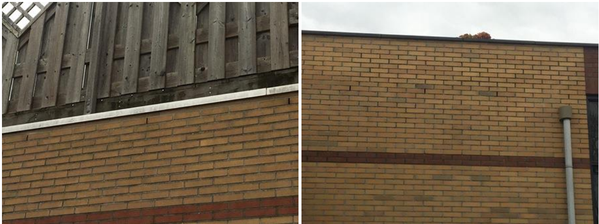
Open stootvoegen in de buitengevel. De open stootvoegen vormen een potentiële invliegopening voor vleermuizen die een verblijfplaats bezetten in de spouw.
