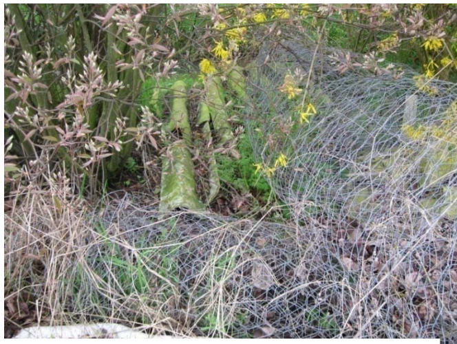
Foto: Asbest golfplaat op het maaiveld
