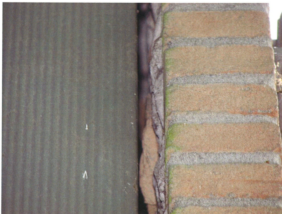
Foto 6: De openingen in de gevel nabij de entree van de sporthal duiden op een mogelijke verblijfsplaats van vleermuizen.
