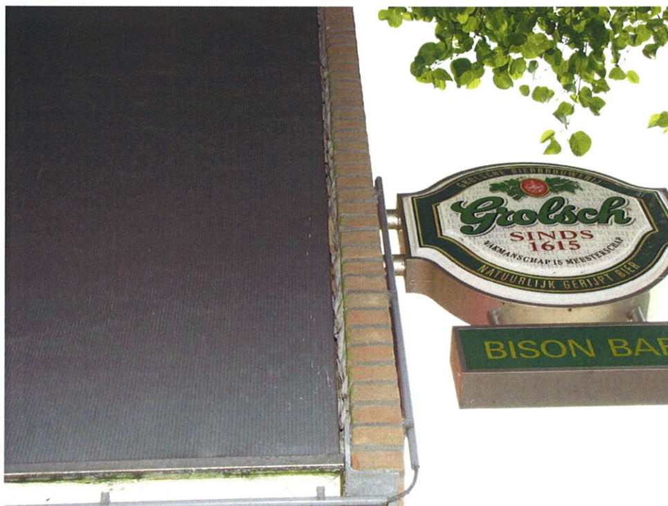
Foto 7: Openingen in de gevel nabij de entree.
