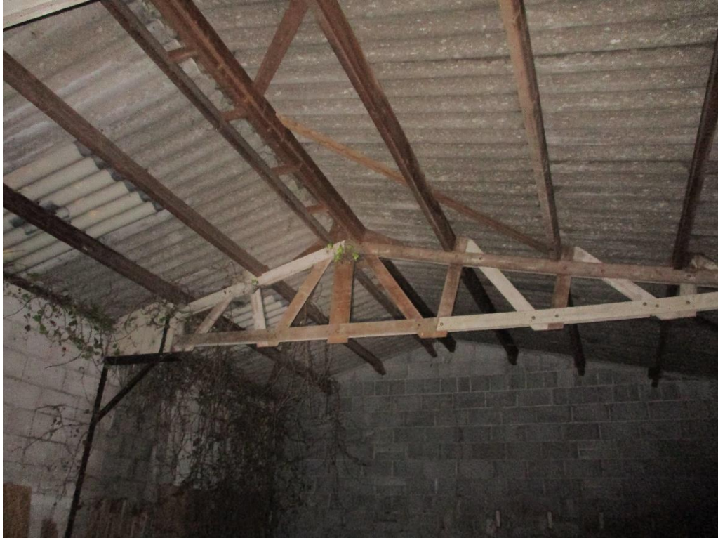
Figuur 3 Een groot deel van de dakconstructie heeft geen dakbeschot.
