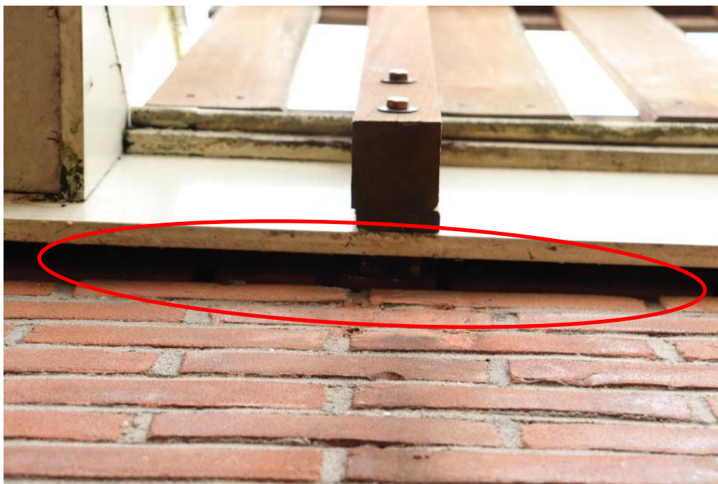
Figuur 2 De multiplex platen aan de achterzijde van het pand sluiten niet goed aan, waardoor vleermuizen hier toegang kunnen krijgen tot de spouw
