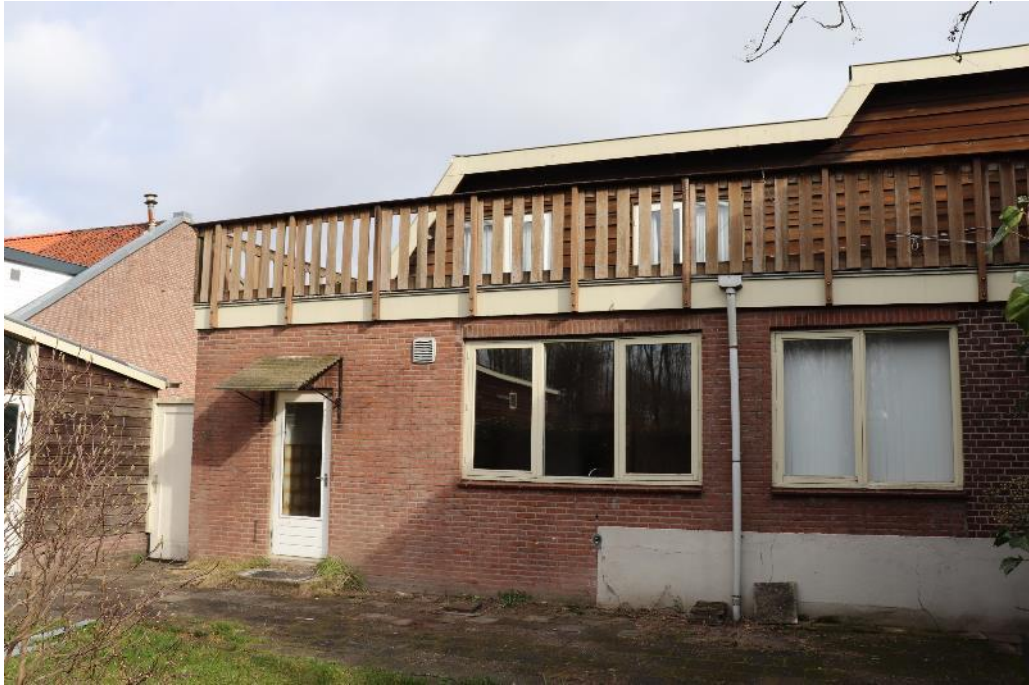
Figuur 3 De aanbouw met spouwmuur en dakterras aan de achterzijde van het pand. De multiplex platen sluiten niet goed aan waardoor vleermuizen toegang kunnen krijgen tot de spouw
