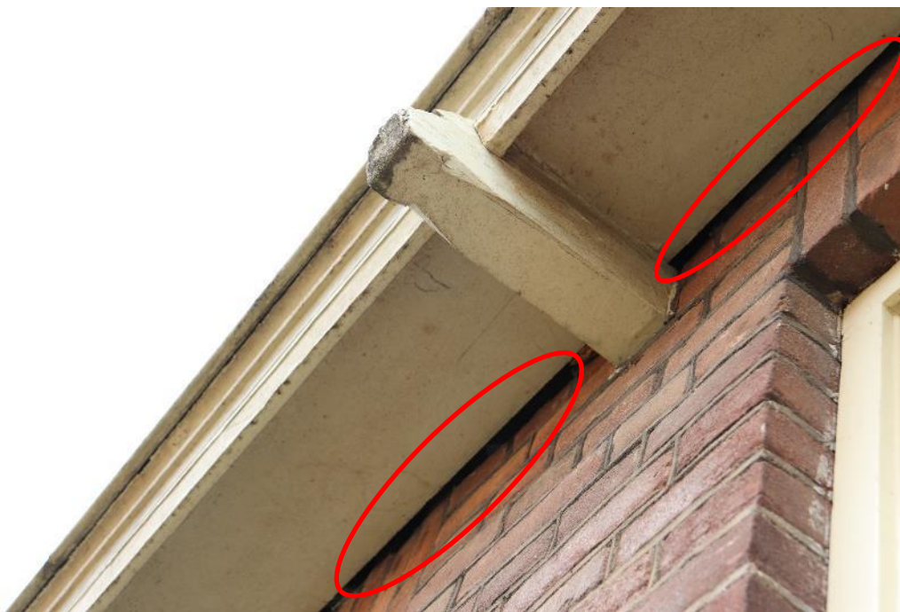
Figuur 2 De dakgootrand aan de noordzijde sluit niet goed aan, waardoor vleermuizen hier toegang kunnen krijgen tot de ruimte onder het dak.
