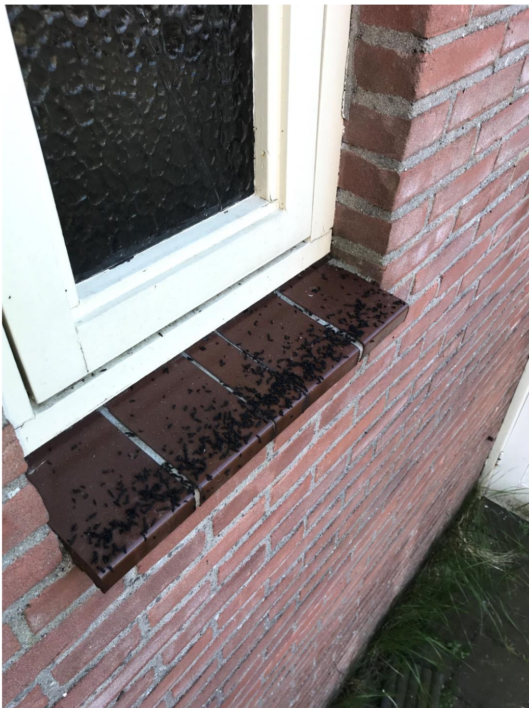
Figuur 1.4 Tijdens een inspectie op 24 juni 2019 zijn veel uitwerpselen van gewone dwergvleermuis aangetroffen (Foto: G.J. van Os).
