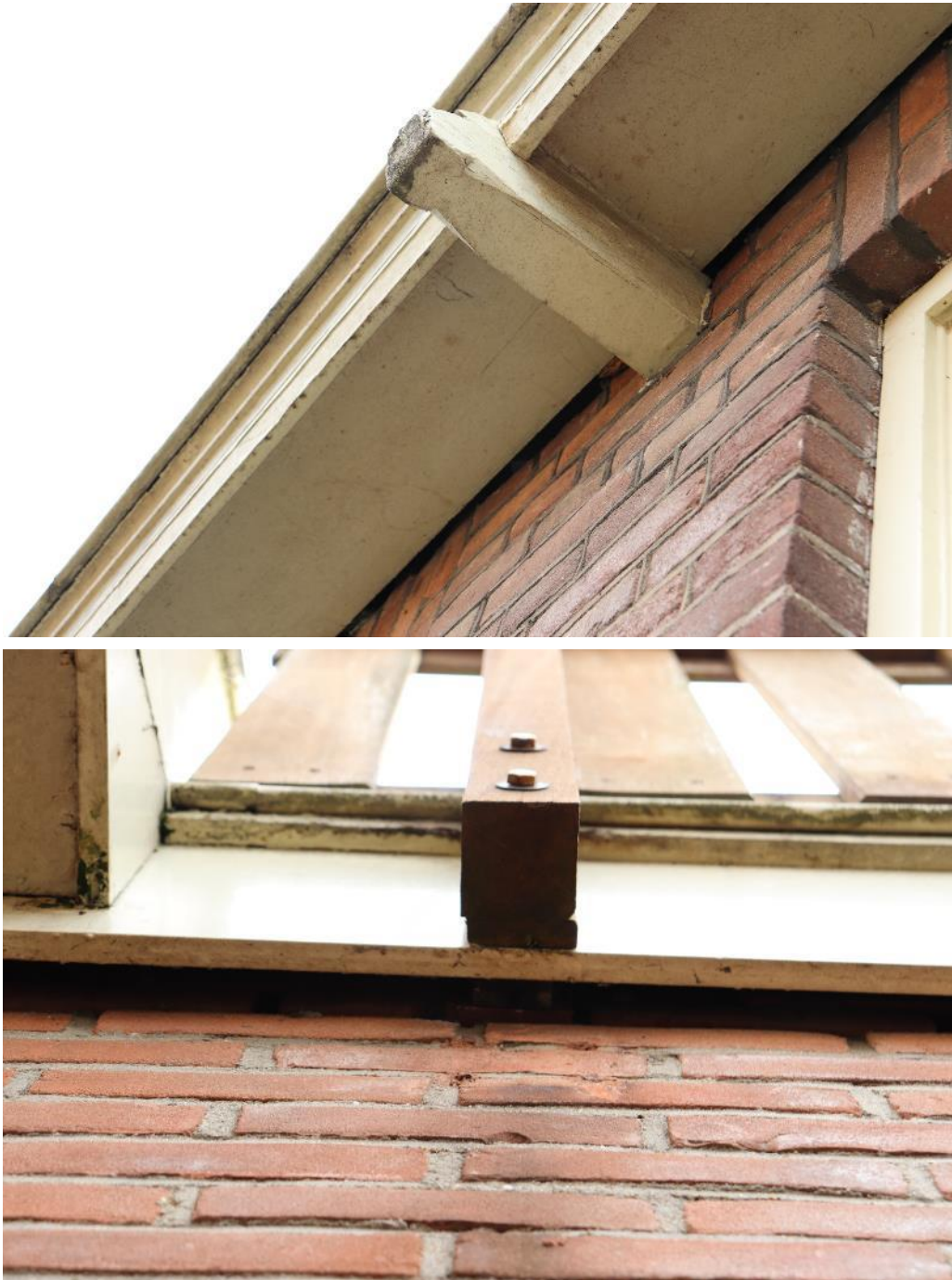
Figuur 1.3 De dakgootrand aan de noordzijde sluit niet goed aan, waardoor vleermuizen hier toegang kunnen krijgen tot de ruimte onder het dak. De multiplex gevelbetimmering aan de achterzijde van het pand sluiten niet goed aan, waardoor vleermuizen hier toegang kunnen krijgen tot de spouw (bron foto's: Schuuring, 2019).
