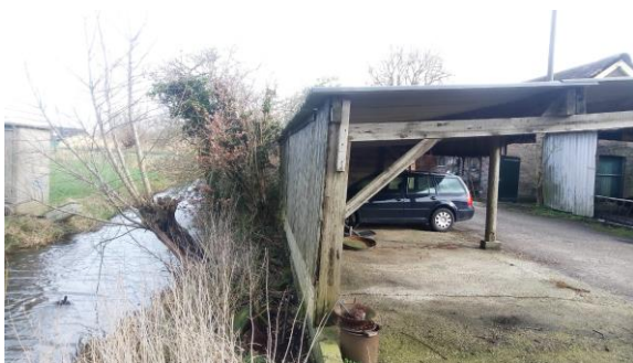
Foto 4: Carport met asbestverdachte dakbedekking. De carport watert af aan de achterzijde, waar geen verharding aanwezig is.
