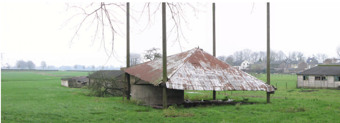
Bestaande bouwval met de aanwezige (deels) ingestorte bouwwerken op het perceel aan de Oostkanaaldijk. Rechtsachter is het buurtschap zichtbaar.
