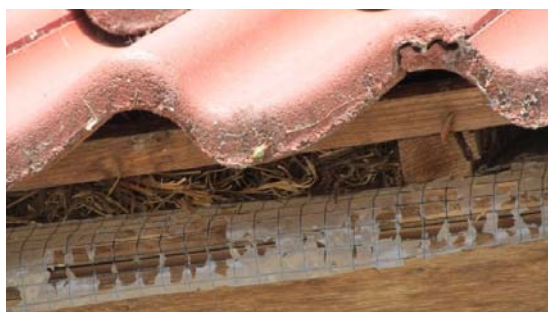
Afbeelding 5 Mussennesten onder dakrand van de schuur
