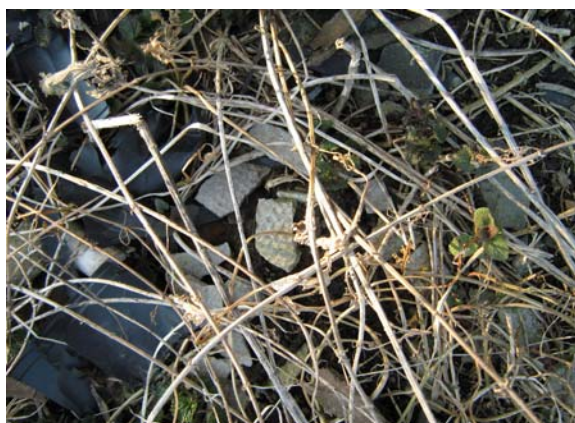
Asbest op maaiveld
