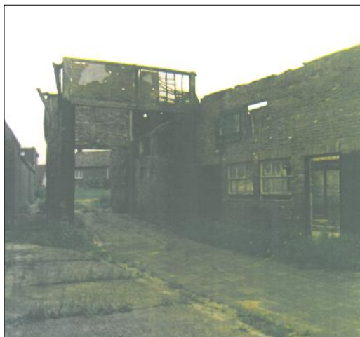
vervallen bijgebouwen op het achtererf
