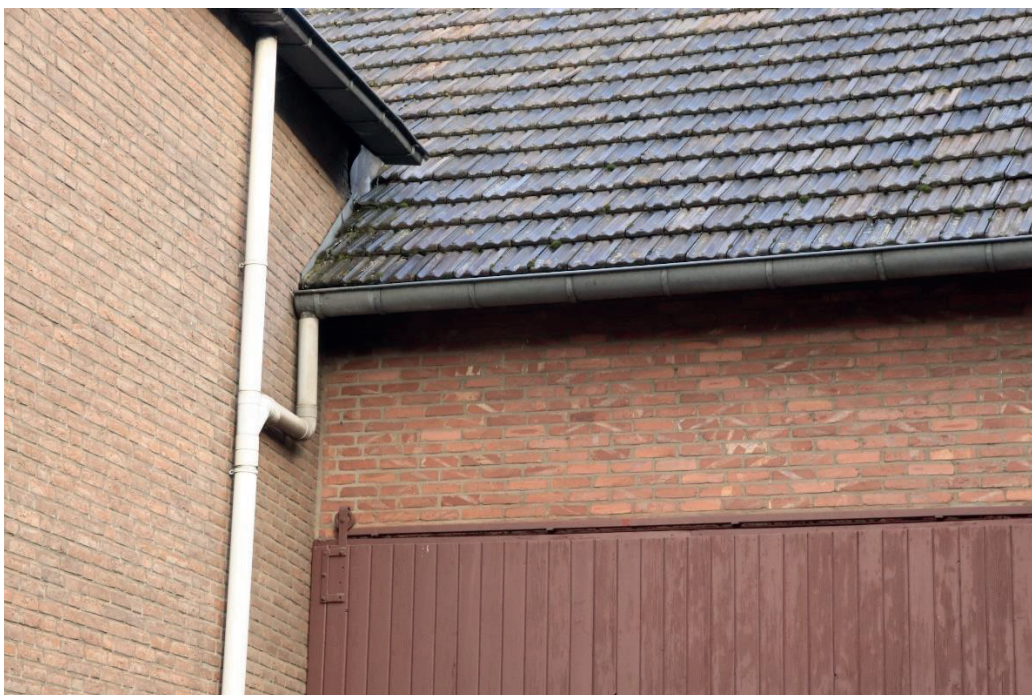
Foto 2: De dakconstructie is ongeschikt voor broedvogels met jaarrond beschermde nesten. De dakpannen zijn ook plat en niet gebold, zodat er geen ruimte onder de pannen en het dakbeschot is om te nestelen.
