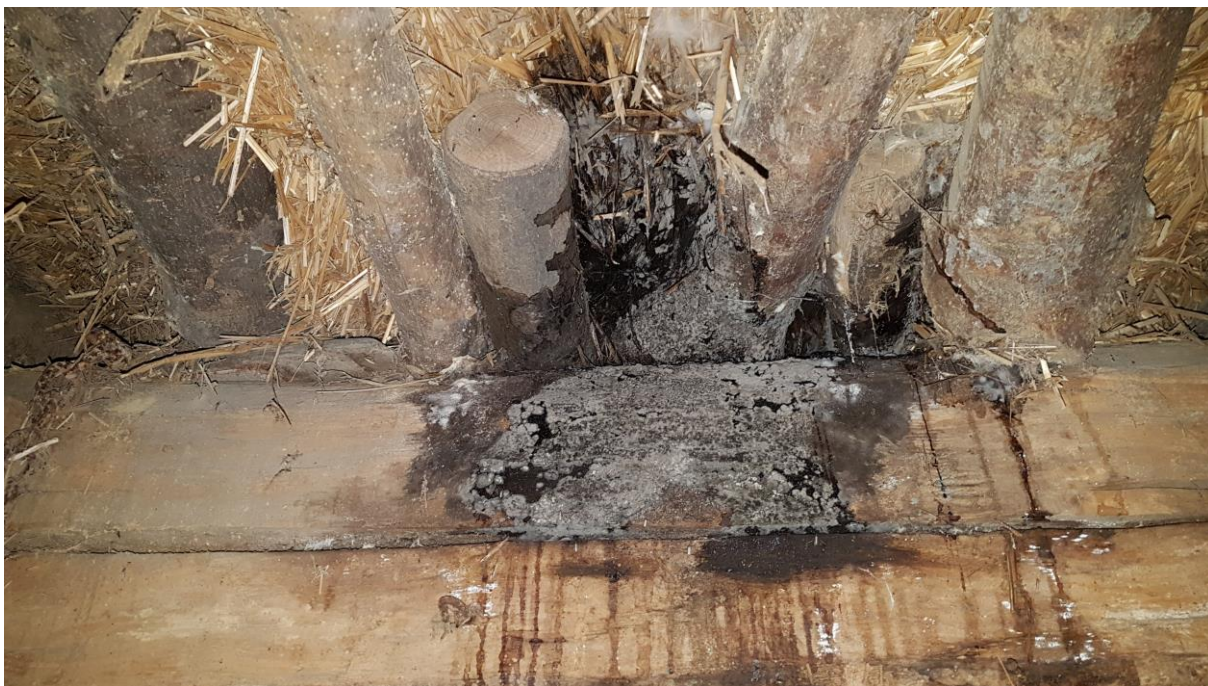
Foto 13: zwarte plekken met vocht aan de onderkant van de hooizolder na inspectie stonk dit niet.
