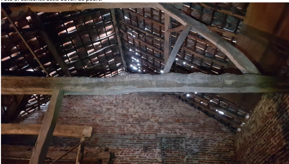
Foto 4: dakconstructie in de noordelijke schuur die voor opslag wordt gebruikt. N.B. op de balk zitten meerdere krijtstrepen.
