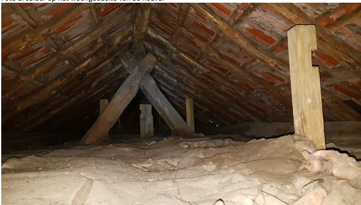
Foto 2: zolder op het woongedeelte van de care hoeve. Het is goed te zien dat de pannen niet goed aansluiten.
