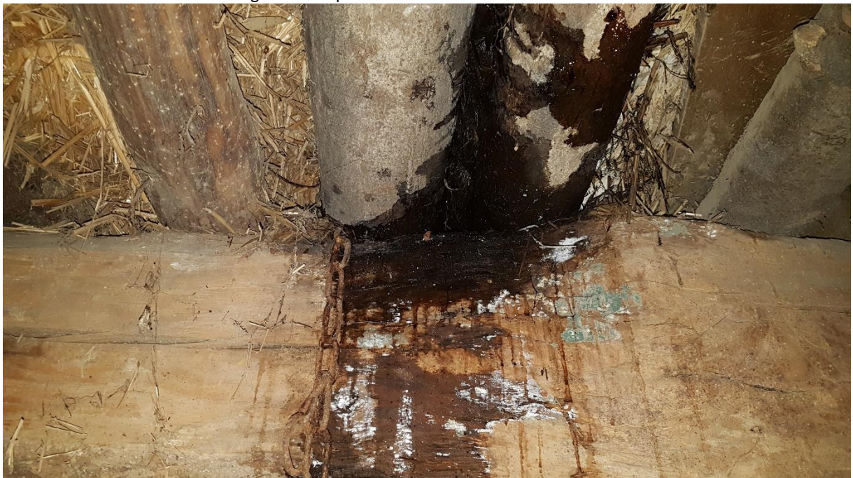
Foto 12: zwarte plekken met vocht aan de onderkant van de hooizolder na inspectie stonk dit niet.
