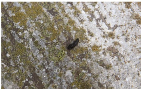
Uitwerpsel gevonden onder de oostvleugel waar een smalle opening onder de dakgootconstructie is aangetroffen
