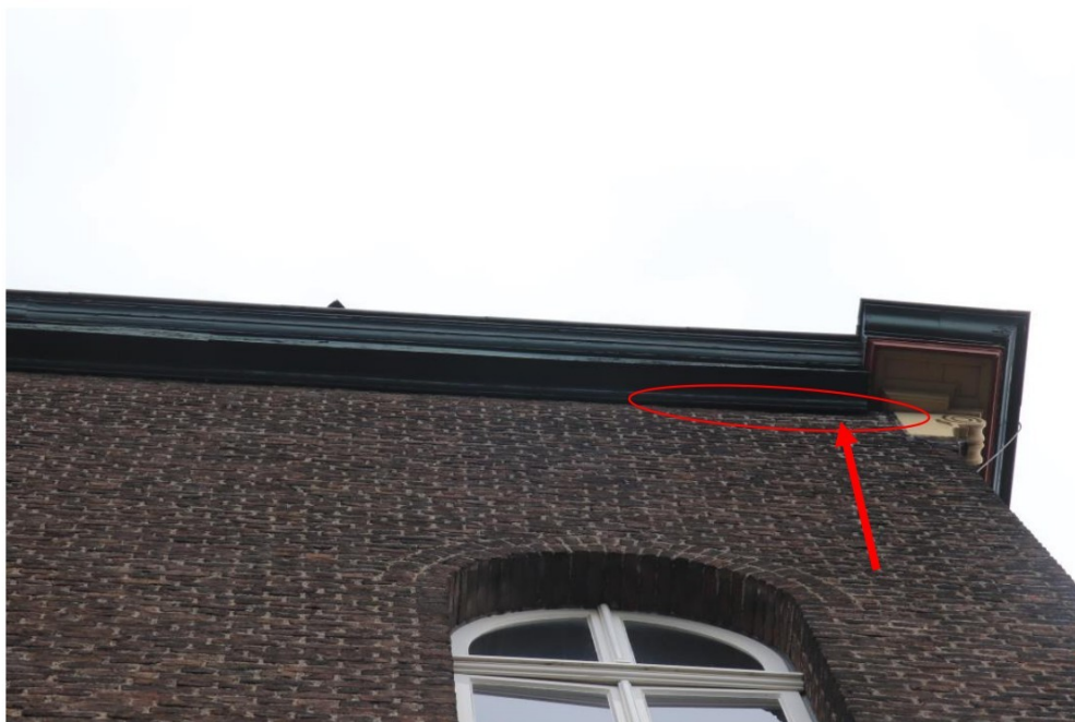
Ingang kraamverblijfplaats Laatvlieger onder dakgoot constructie westzijde gebouw
