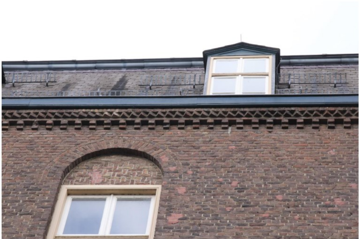
Foto 2: De dakconstructie is voor soorten als gierzwaluw, huiszwaluw en huismus ongeschikt om als broedplek te dienen.
