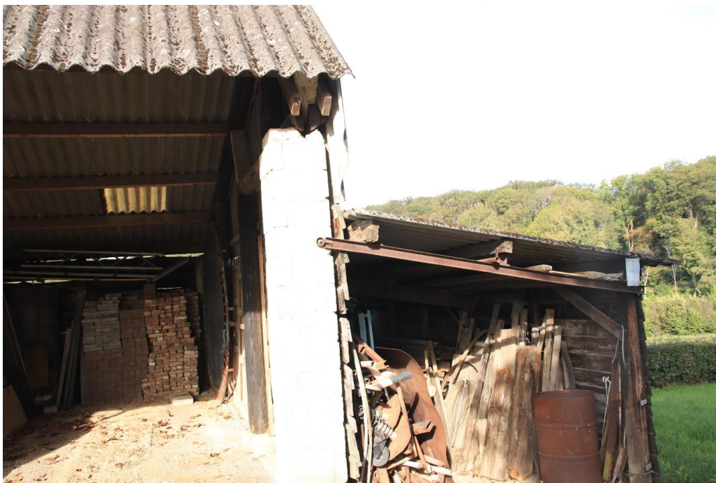
Foto 5: Er zijn geen geschikte plekken voor vleermuizen om het gebouw binnen te treden. De openheid van de schuur en de aanwezigheid van asbestplaten werkt zeker niet in het voordeel van vleermuizen
