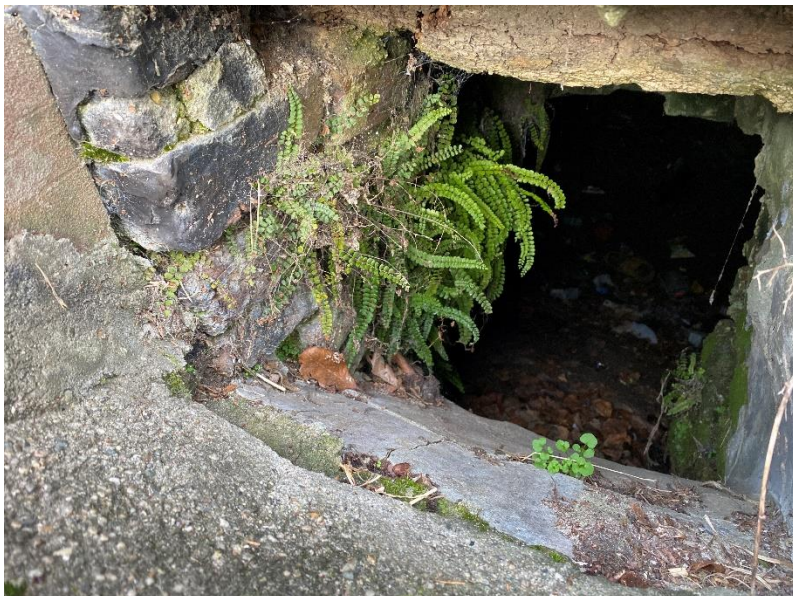
Foto 4: steenbreekvarens bij opening van de kelder aan de straatzijde
