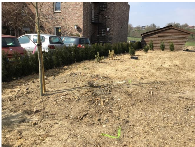
Asbest op maaiveld-1
