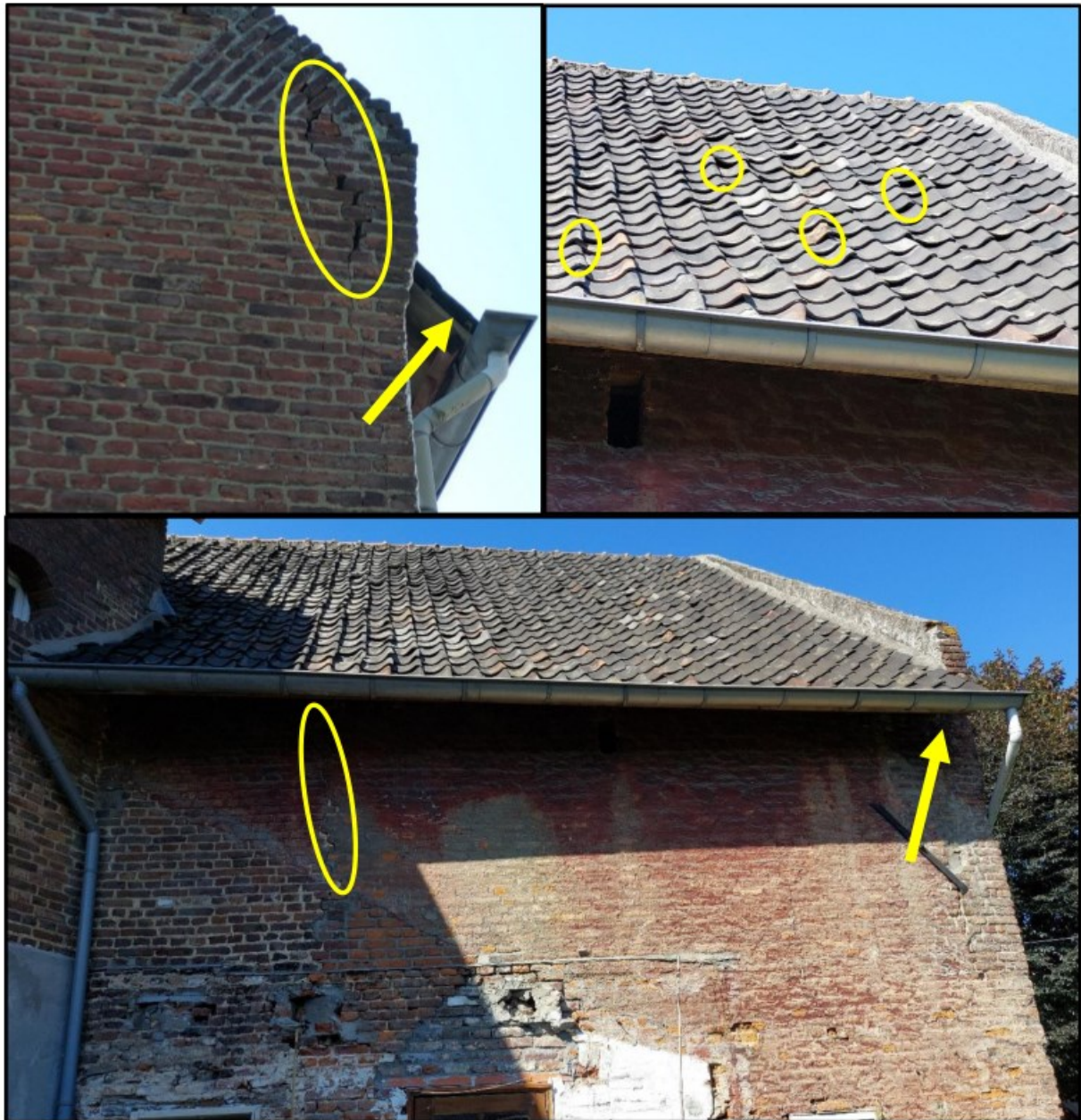
Figuur 4.1 Weergave van enkele voorbeelden van locaties potentiële verblijfplaatsen vleermuizen ter plaatse van scheuren, dakpannen en achter de dakgoot (zie gele markeringen).
