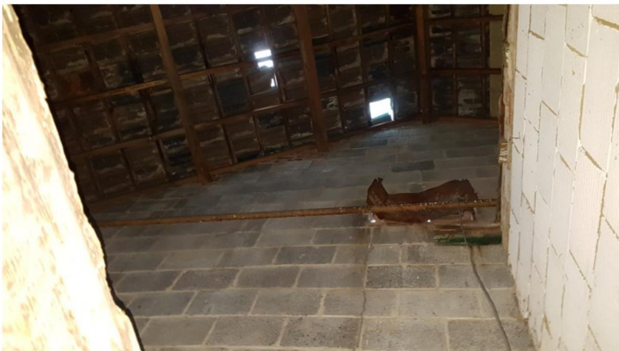
Foto 10: dak zonder dakbeschot waarbij een paar pannen ontbreken. Ook zijn de drie vensters bedekt met een metalen plaat.
