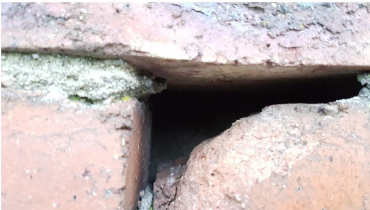
Foto 14: gat in de gevel naar de spouwmuur.
