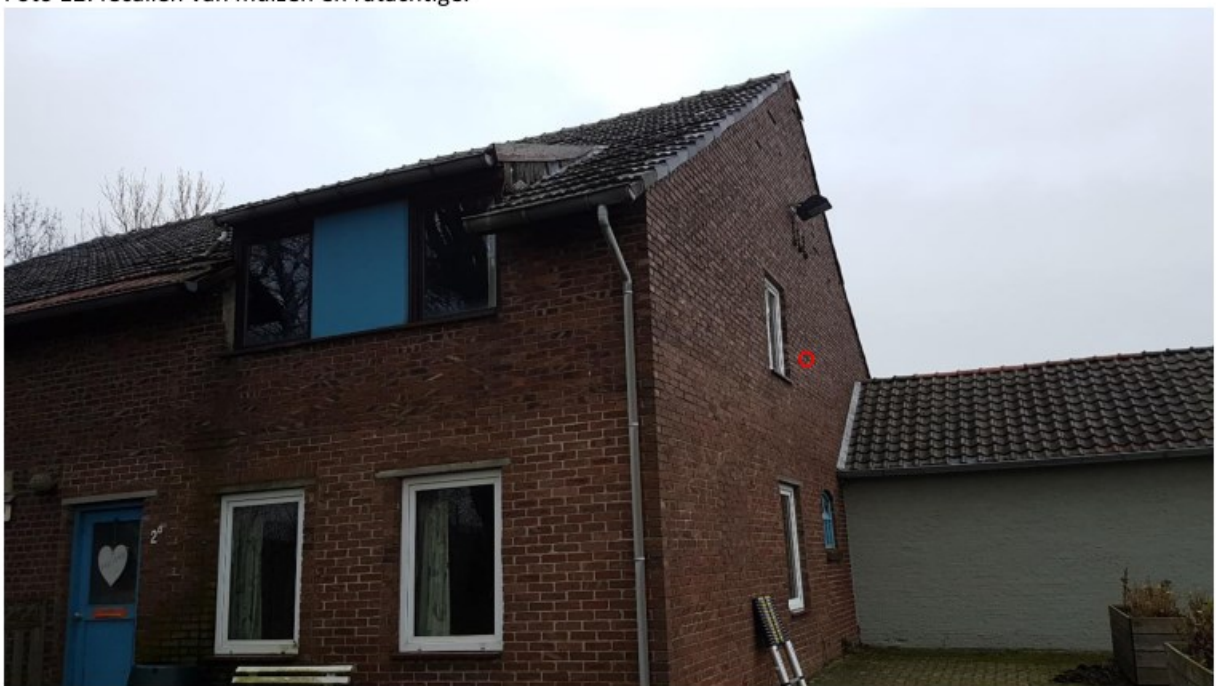
Foto 13: de westelijke gevel met de gevellamp, drie vensters, en het gat (aangegeven met de circkel).
