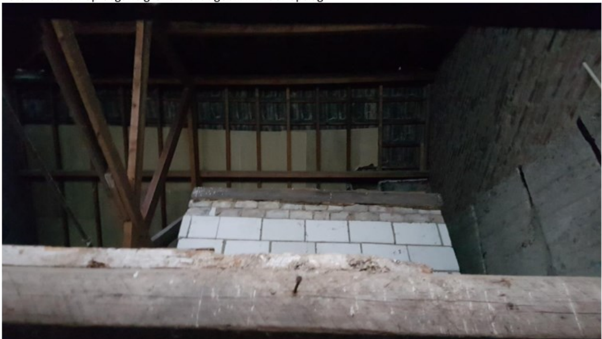
Foto 4: binnen de schuur is zicht op de binnen muren van het woonhuis, ook is te zien dat er dakbeschot is geplaatst bij een klein gedeelte van het dak. zie ook de fecaliën van vogels op de balk.
