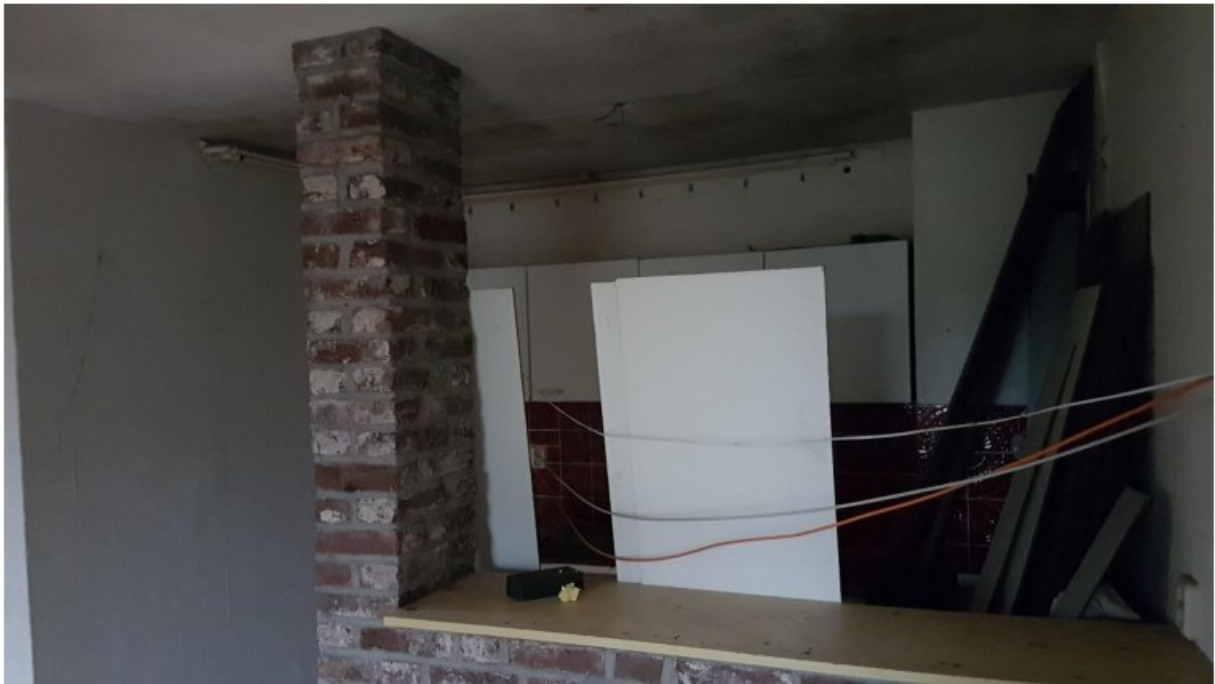
Foto 3: keuken op begane grond wordt gebruikt voor opslag.
